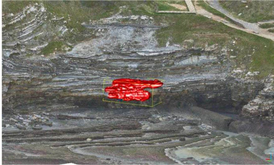
Illustration 65 - Identification sous Cloudcompare© de la rupture de dalles rocheuses, en partie sud-ouest du secteur de Sainte-Barbe, entre 2019 et 2020 (vue 2020, en rouge : zone érodée ; ©Observatoire de la Côte Aquitaine, Hélimap)
