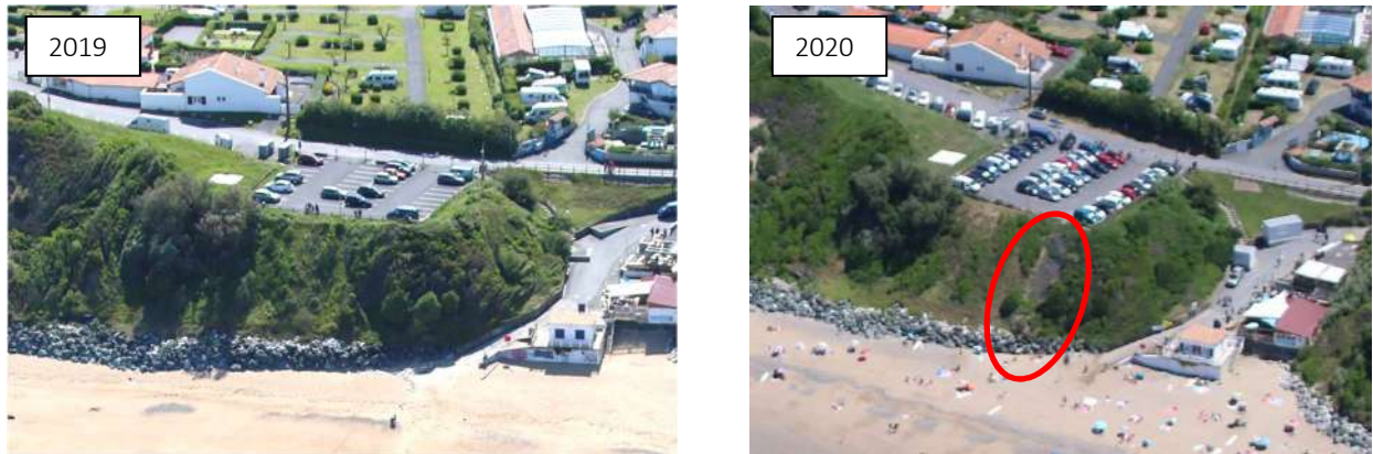
Illustration 36 - Zone de glissement en partie centrale du secteur de Mayarko, ayant été traitée, en mars 2020, par revégétalisation (©Observatoire de la Côte Aquitaine, Olivier Chaldebas, ULM Sud Bassin, 2019 et 2020)
