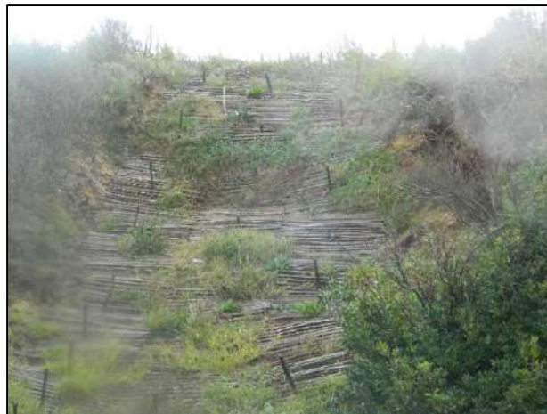
Illustration 37 - Zone de glissement au droit du parking ; cicatrice ayant fait l'objet, en mars 2020, d'une action de revégétalisation (©Observatoire de la Côte Aquitaine, 2020)
