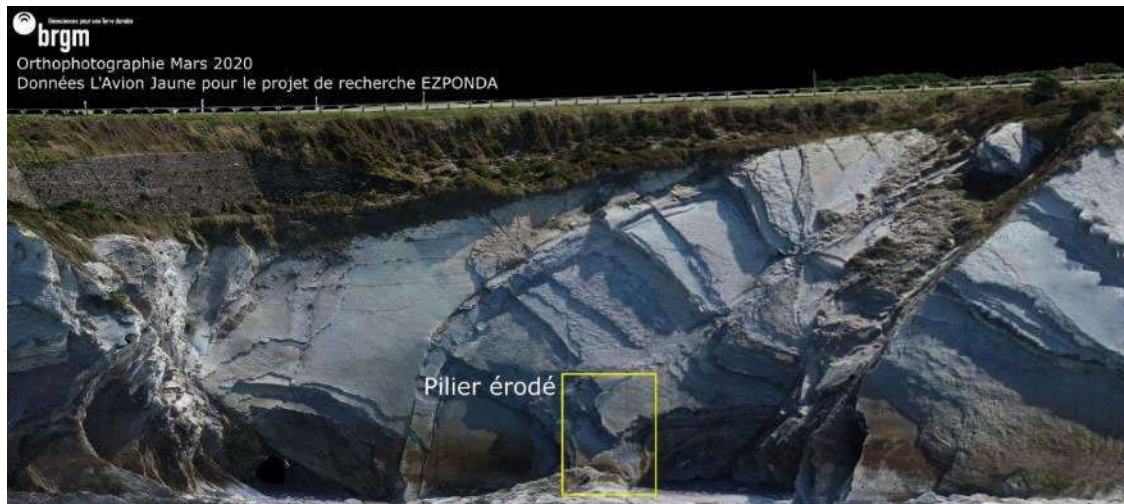
Illustration 8 - Tronçon 5 : orthophotographie en élévation (projection sur un plan vertical) du 10 mars 2020 ; dans le cadre jaune, pilier supportant les couches sus-jacentes récemment érodé (données l'Avion Jaune pour le projet EZPONDA)
