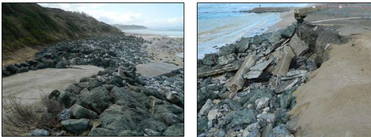
Figure 64 : Destruction hélisation et accès plage du Centre, tempête Christine (Bidart, 06/03/2014, BRGM).
