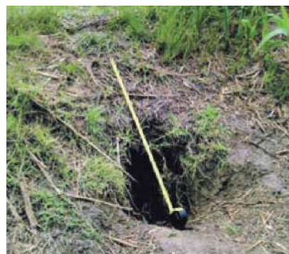
Photo extraite du Magazine du Vidourle légendée « Terrier dégradant les berges ». bit.ly/2JDcclV
