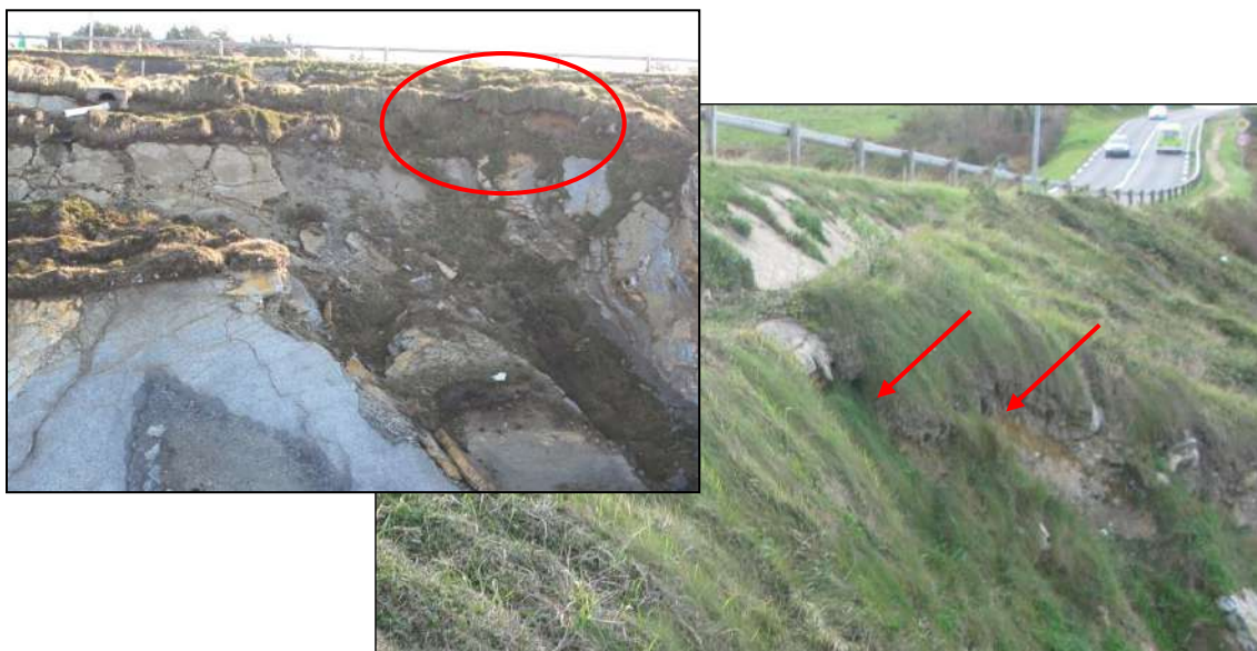
Illustration 18 : sous-cavage de la branche sud-ouest du fossé bétonné en tête de falaise - tronçon 7
