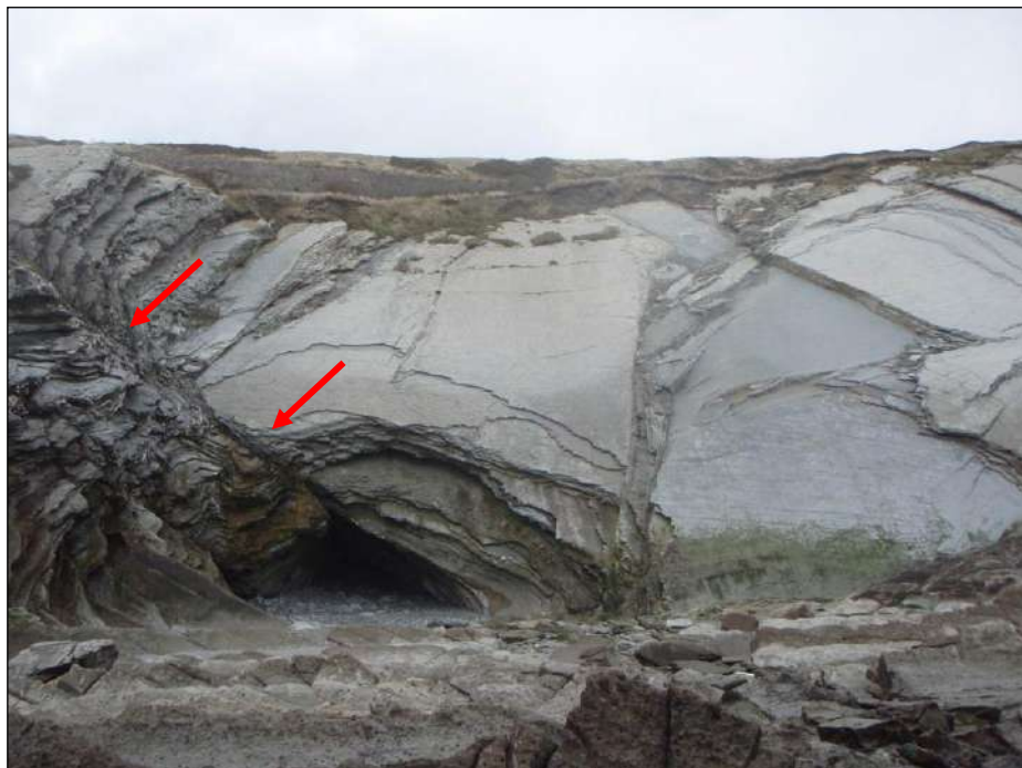
Illustration 5 : Zone de sous-cavage en pied de falaise favorisé par la présence d'une faille (flèche)
