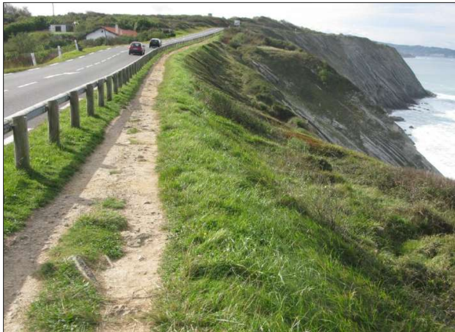
Illustration 13 : Contexte de bordure de falaise au droit du tronçon 5
