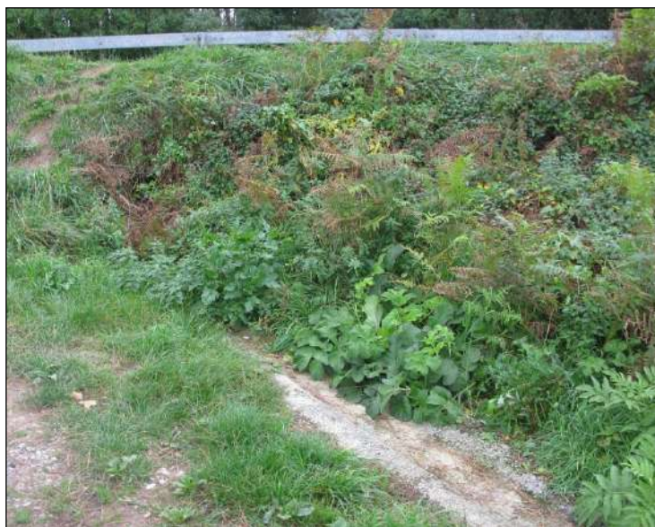
Illustration 36 : Caniveau bétonné en aval de la route en partie envahi par la végétation – tronçon 19
