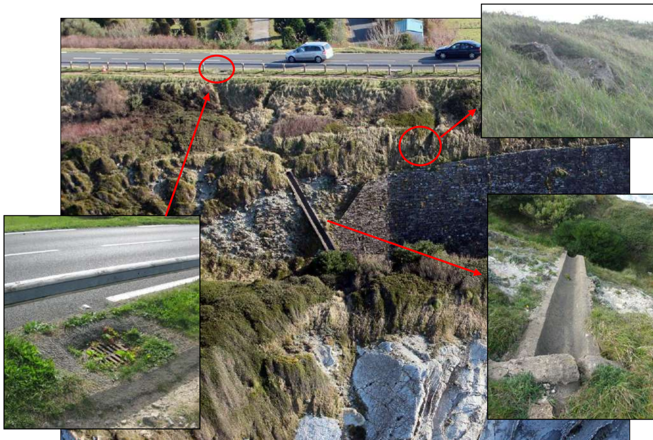
Illustration 14 : Gestion des eaux pluviales au droit du mur de soutènement - tronçon 5 (cliché central Balloïde Photo, 2012)
