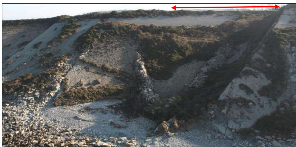
Illustration 29 : Identification de la zone sur laquelle des rejets direct en tête de falaise d'eaux pluviales sont possibles (cliché Balloïde Photo, 2012)
