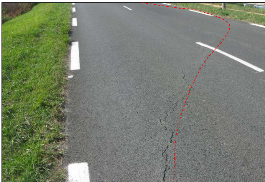
Illustration 11 : Fissuration sur chaussée au droit du tronçon 2
