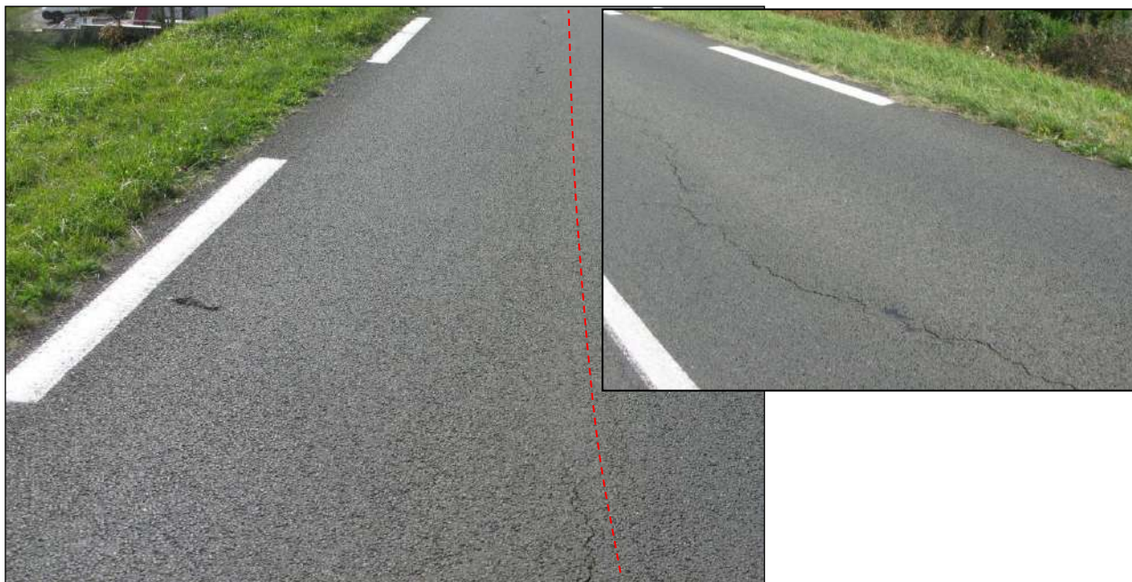
Illustration 12 : Fissuration sur chaussée au droit du tronçon 5
