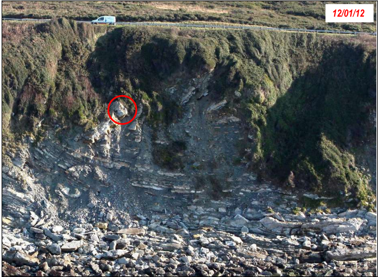
Illustration 55 : Vues de détail zone 1 - tronçon 17 (cerclé : bloc basculé dans la pente)
