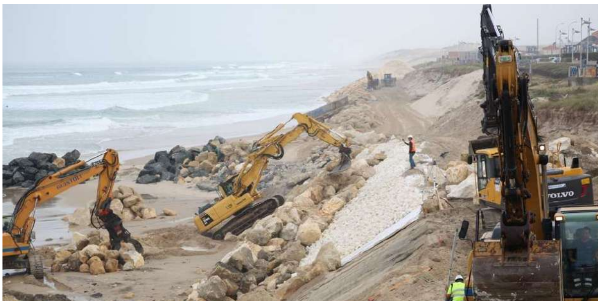
Figure 24 : Travaux de reconstruction des défenses du front de mer à Lacanau-Océan au printemps 2014 (Source : Sud-Ouest)
