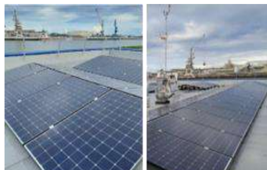
Installation solaire de la capitainerie du port de plaisance du Brise-Lames à Anglet (source : @CAPB)
