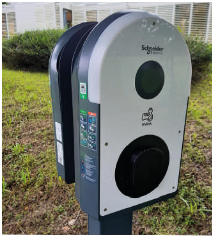
Borne installée en juin 2024 sur le site de Zaluaga à Saint-Pée-sur-Nivelle (direction PCVD). © SG TEPE
