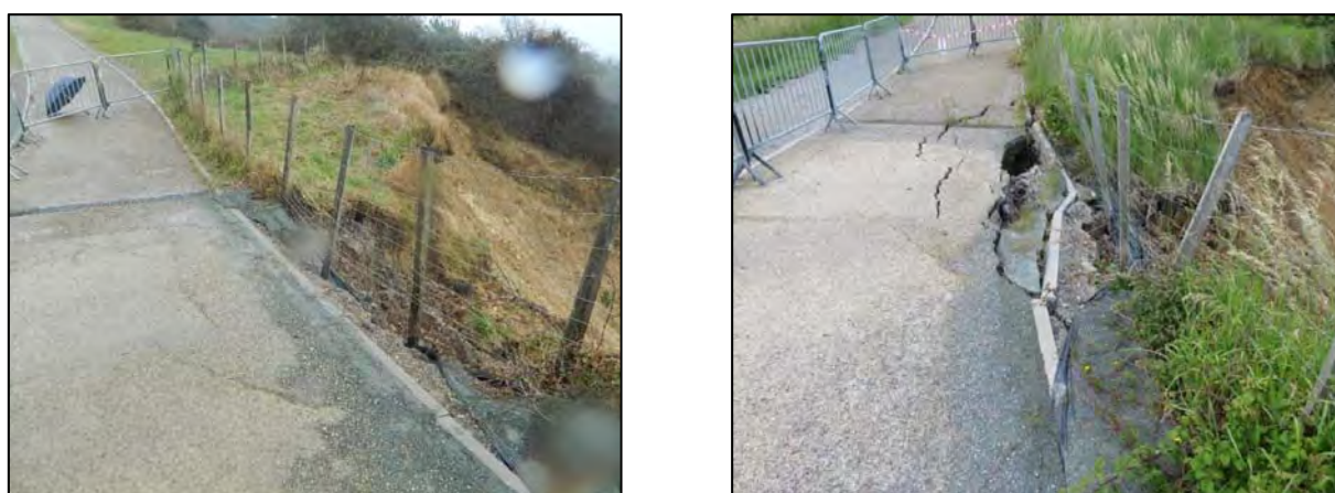
Illustration 43 - Impact sur la Vélodyssée de la cinquième zone de glissement, à Erromardie ouest (clichés datés de février 2019, à gauche, et avril 2019, à droite)
