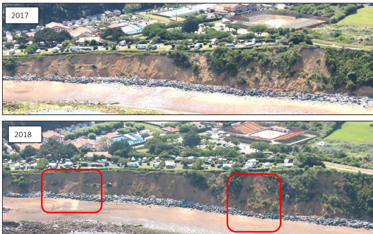
Illustration 41 -Zones en glissement (troisième zone à gauche et quatrième zone à droite), au droit du camping de bord de mer, dans le secteur d'Erromardie ouest (@Observatoire de la Côte Aquitaine, Olivier Chaldebas, ULM Sud Bassin, 2017 et 2018)
